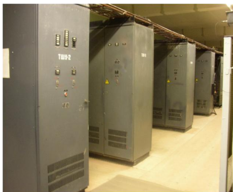
Рис. 13. Шкафы тиристорных агрегатов питания обмотки тороидального поля
