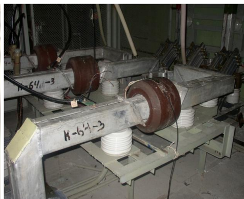
Рис. 14. Разъединитель 10 кВ, 5000 А и измерительный трансформатор тока
