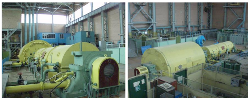
Рис. 5. Электромашинный агрегат ТКД-200 и пультовая установка Т-11М ТКД-200 в энергокорпусе
