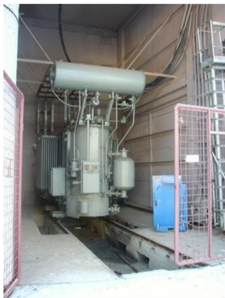
Рис. 10. Разделительный трансформатор 10 МВА
