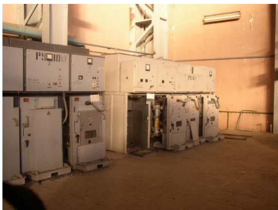
Рис. 8. Комплектное распределительное устройство для питания электромашиного агрегата ТКД-200
