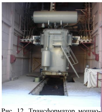
Рис. 12. Трансформатор мощностью 80 МВА для питания двух тиристорных агрегатов
