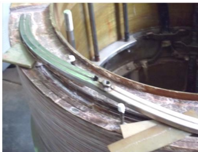
Рис. 2. Последствия аварии на диверторной катушке PF3-U токамака SST-1
